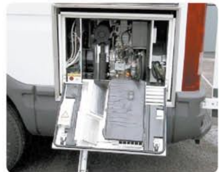
Laboratorio montado en furgoneta. Detalle del generador eléctrico
